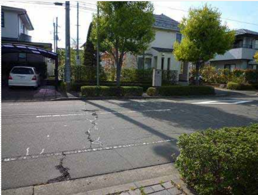
前面道路の亀裂
