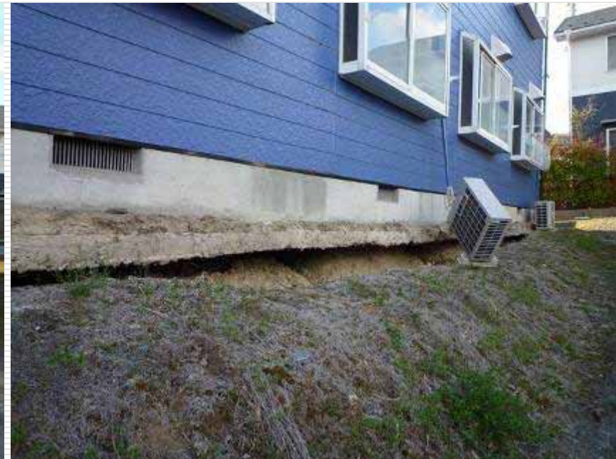
宅地崩壊の詳細
