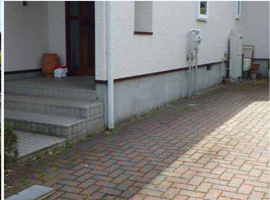
基礎の刷毛引きの損傷
