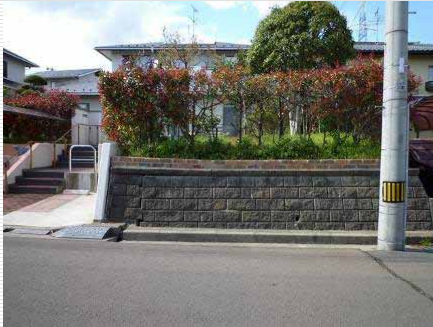
よう壁の破損
