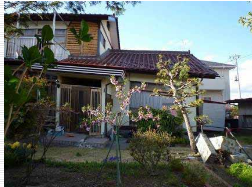
地盤変状による木造住宅の大破。
