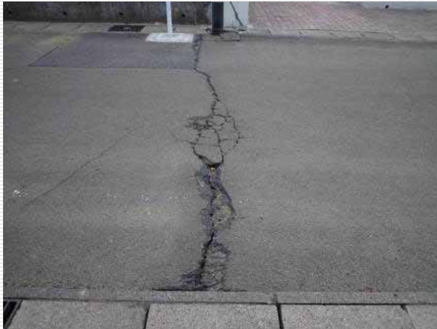
前面道路の亀裂
