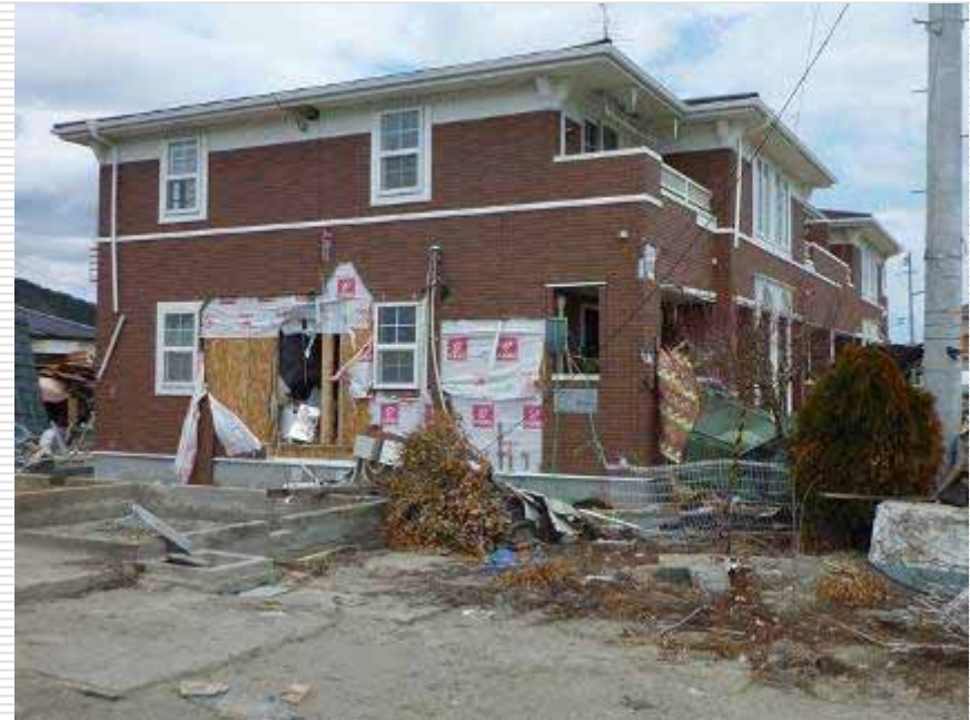
側面の外壁は漂流物の激突のためか仕上げ破損し、構造用パネルが露出
