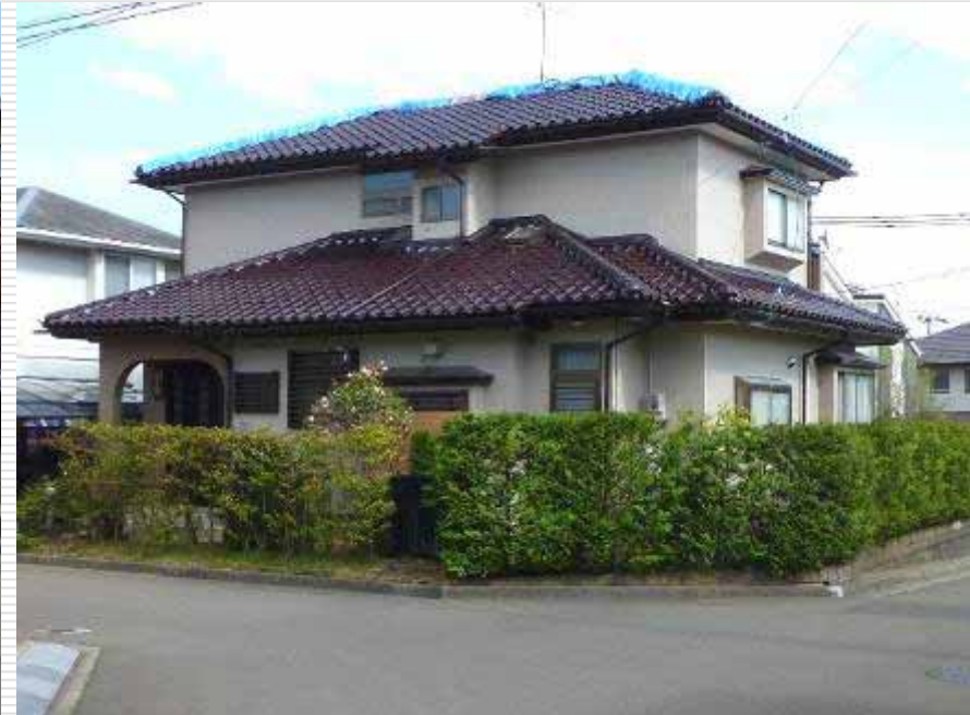
近隣の瓦屋根の被害
