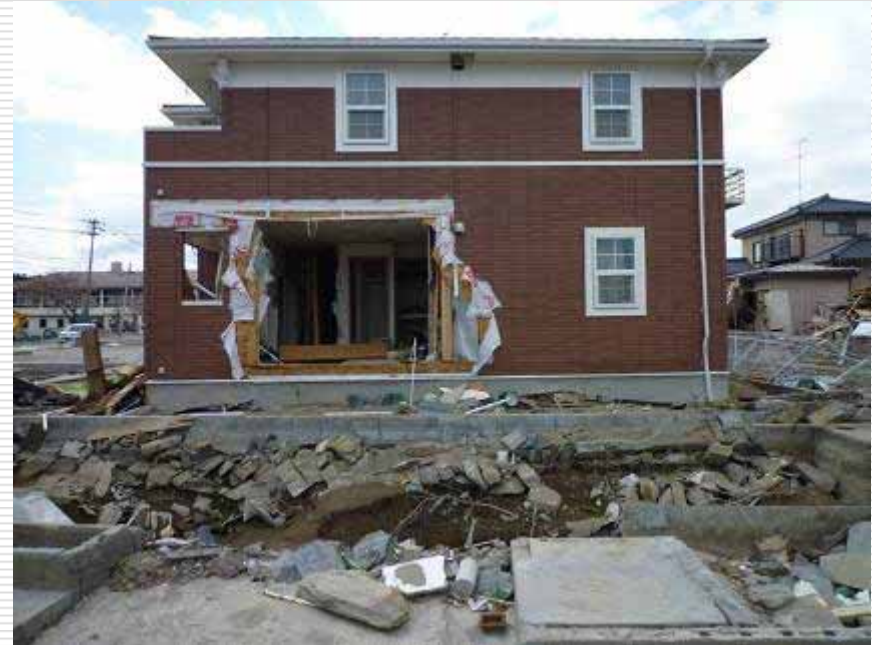
側面の破損状況。津波の流出入の経路が伺える。
