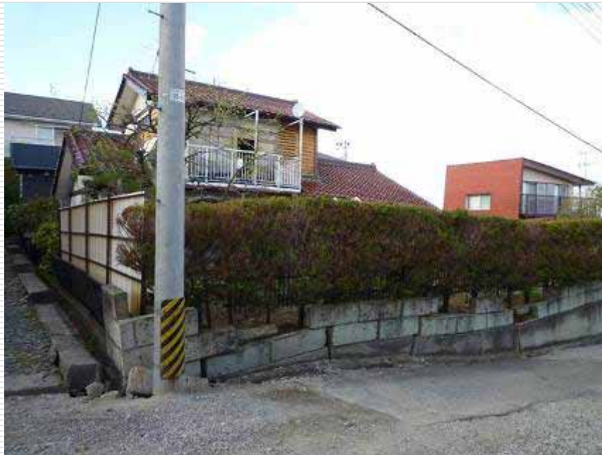
道路及び石塀の損傷状況
