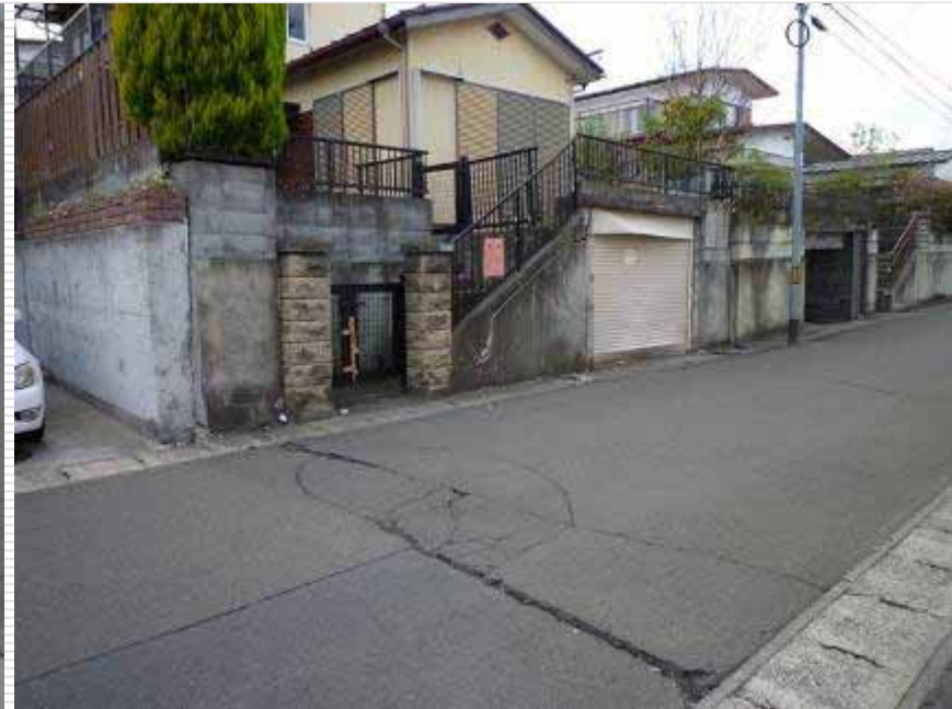
道路の亀裂、車庫の被害
