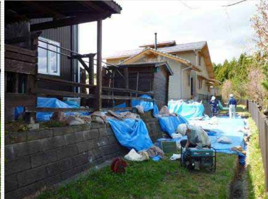
近隣での被害状況
