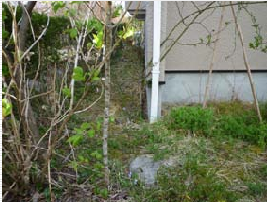
基礎の脇に生じた地盤の隙間
