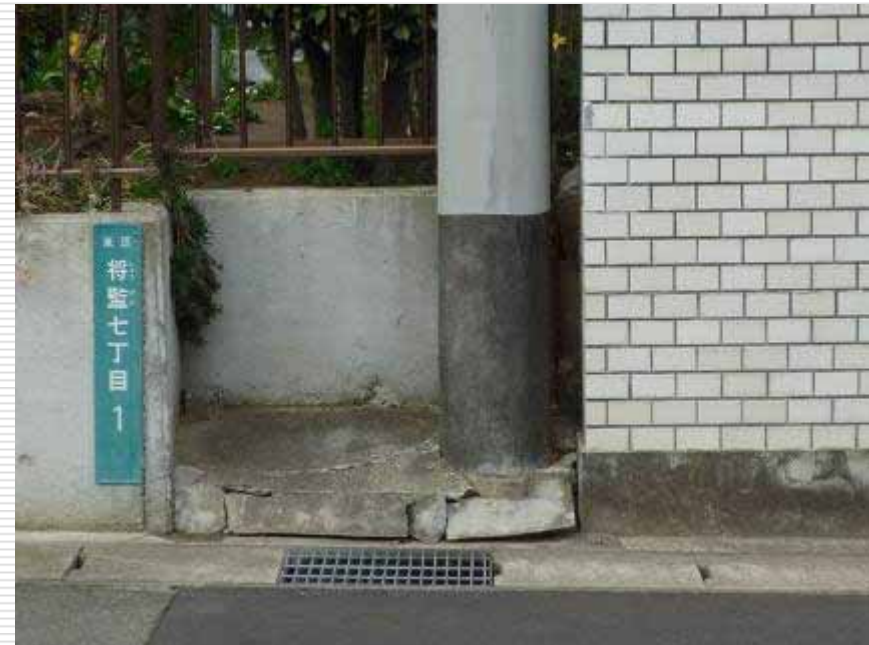
電柱の脚部周辺の損傷
