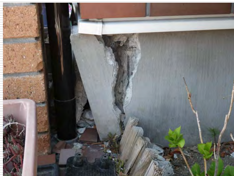
礎隅角部のコンクリートの圧壊
