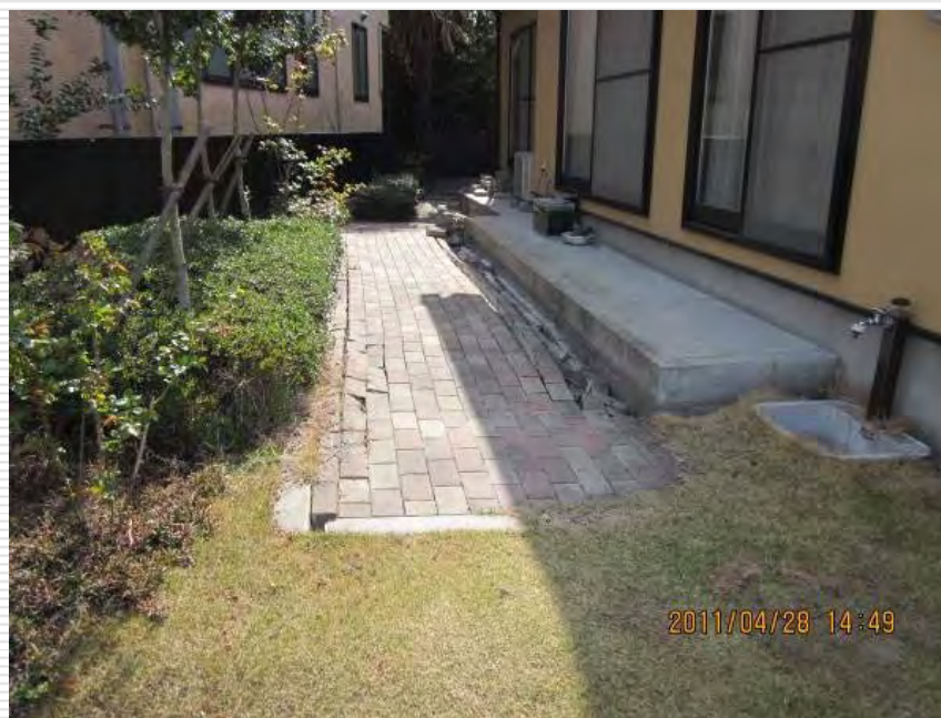
近隣状況・地盤の隆起とひび割れ
