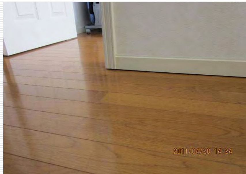
巾木と床面との隙間
