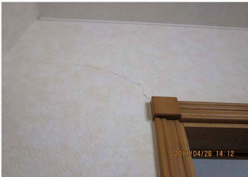
壁クロス割れ
