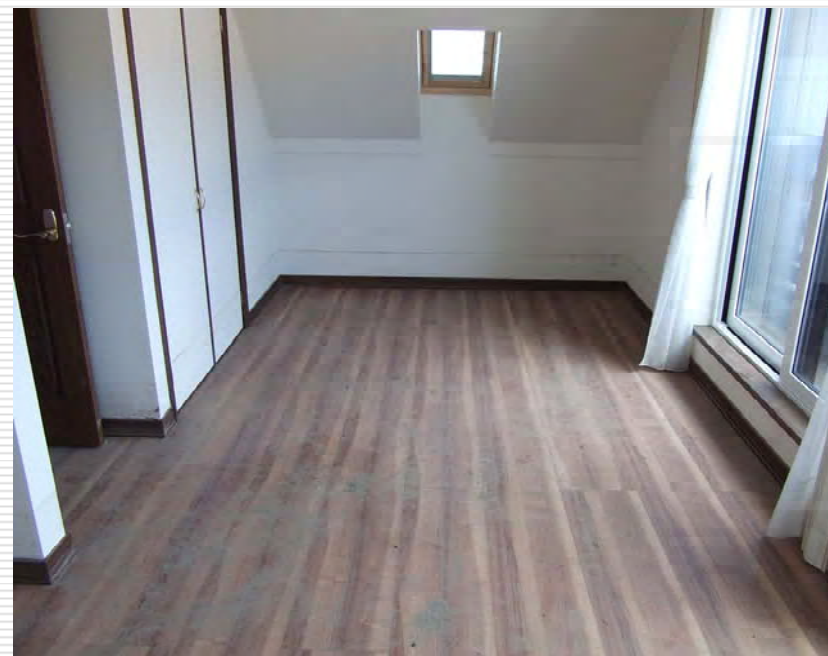
床から30cm程度のところに水跡
