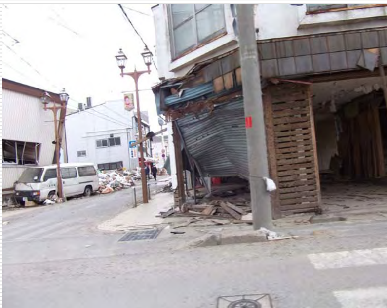
両面開口の店舗建築の被害
