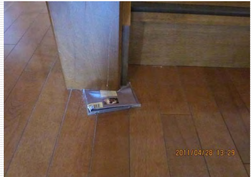
階段手摺笠木にCDケースが挿まれた
