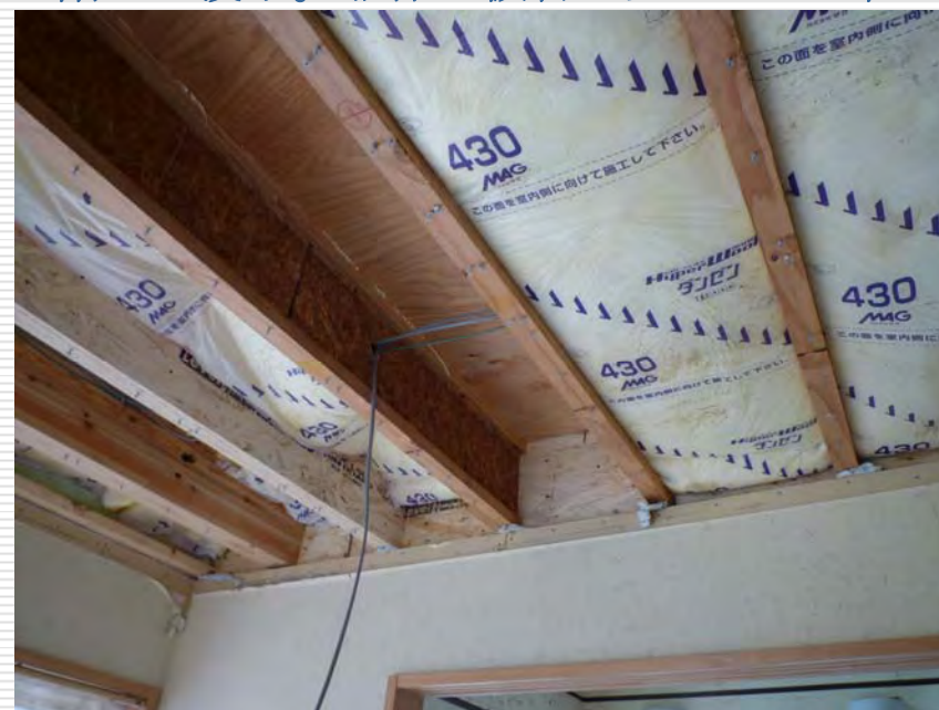
石膏ボードは落ちたが 床根太は被害なし
