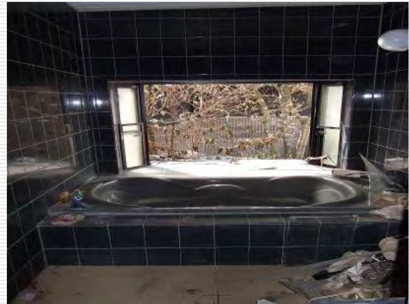
進入した水は浴室窓から流出
