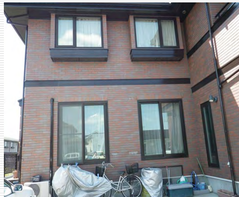
外壁乾式タイルのひび割れ、剥落
