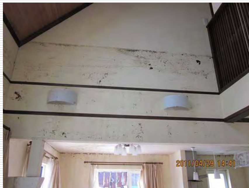
吹き抜け部分の浸水跡
