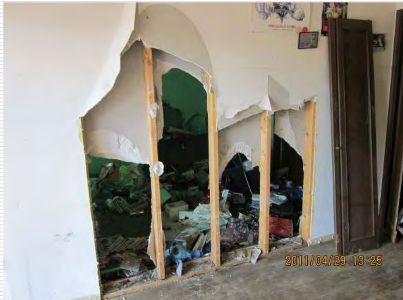
津波が石膏ボード貫通
