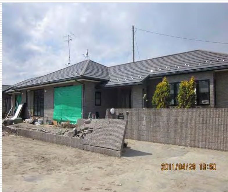
南面掃き出し窓より海水侵入
