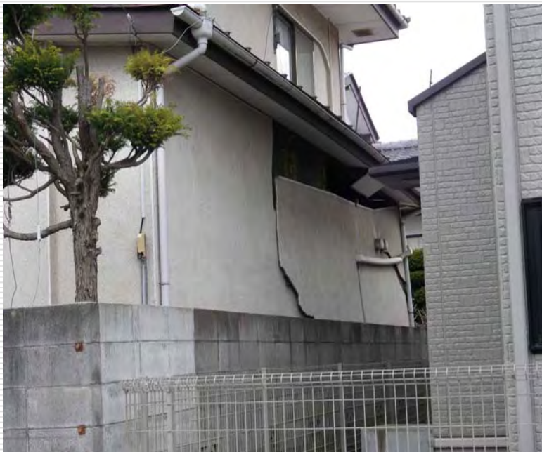
外壁の剥落が生じている近隣住宅
