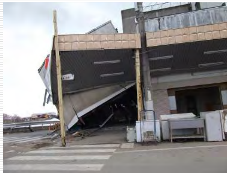
完全に倒壊している店舗
