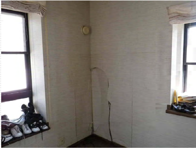
石膏ボードの陥没
