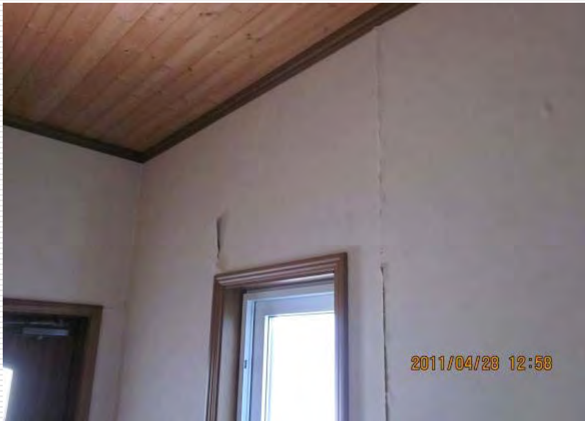
石膏ボード目地部のクロス割れ
