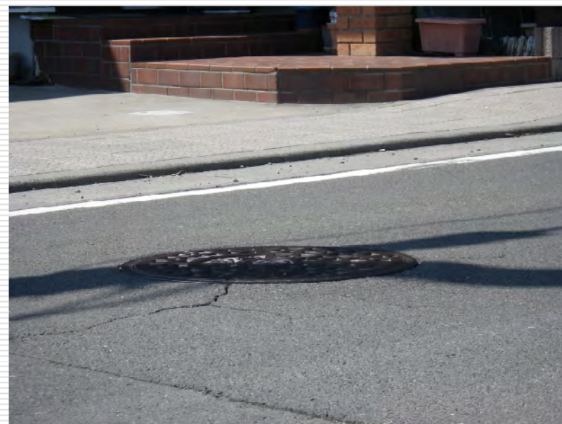
前面道路のマンホールの隆起現象
