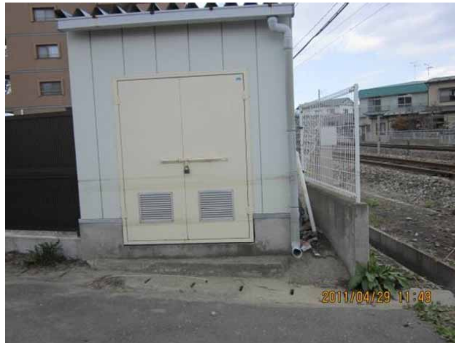
近く建物、浸水跡から約 1m の浸水と思われる
