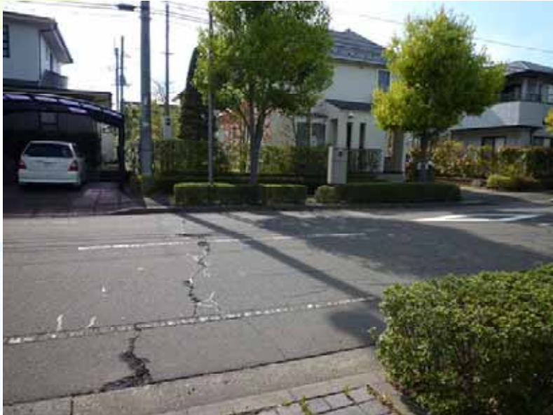
住宅 A-5 の前面道路に生じた亀裂。
