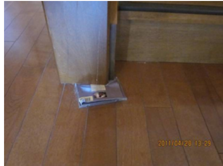
階段手摺下にCDケースが挟まって抜けない、一度壁が浮いたか。
