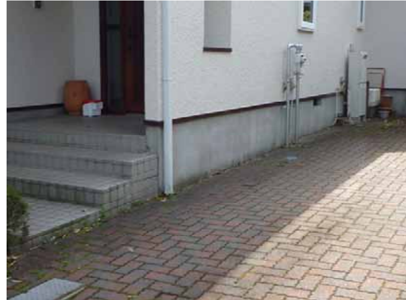
玄関周りの基礎仕上げモルタルの損傷。
