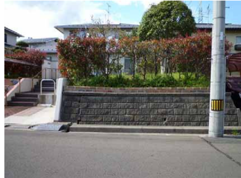
住宅 A-3 擁壁の損傷状況。
