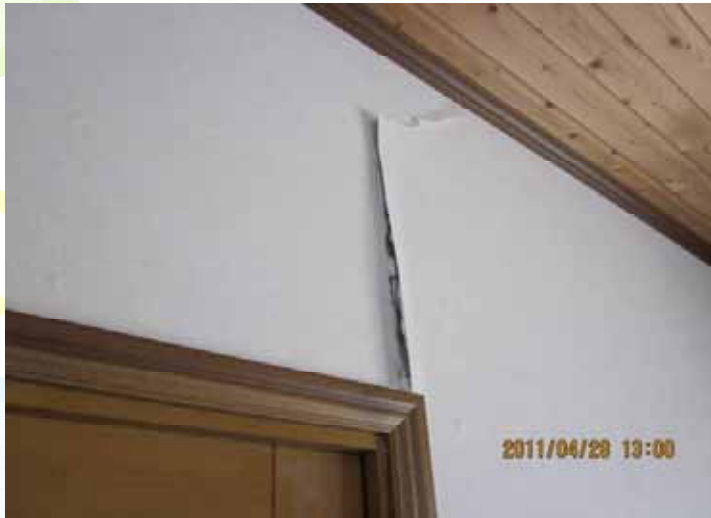
1階せっこうボードのクラック
