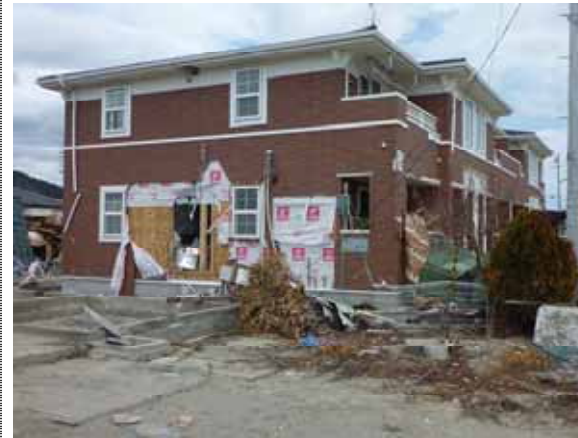
妻面の外壁は漂流物の衝突のためか仕上げが 損傷し、下地の構造用パネルが現れている。
