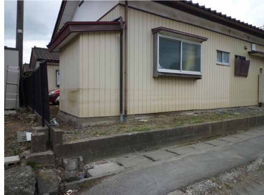
住宅 A-11 近隣での浸水痕跡。
