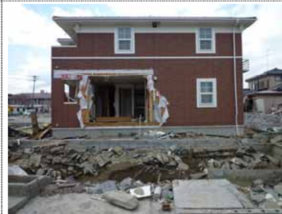
妻面の開口部の損傷状況。
