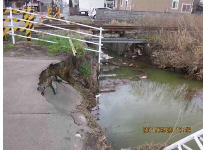
陥没踏切奥が海側(住宅地)。道路端が用水路側に崩落している。
