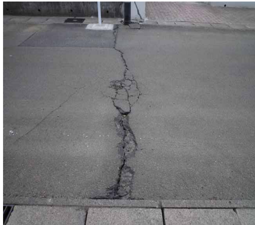
住宅 A-7 の前面道路の亀裂。
