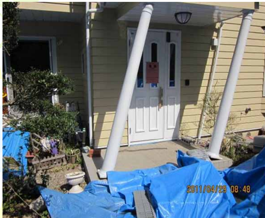
建物ポーチと約 70cm 程ずれている(2*4 建物)
