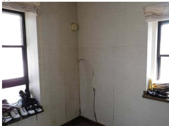
建物隅角部の石膏ボードの陥没
