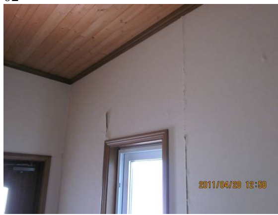
1階石膏ボード目地部のクロス割れ
