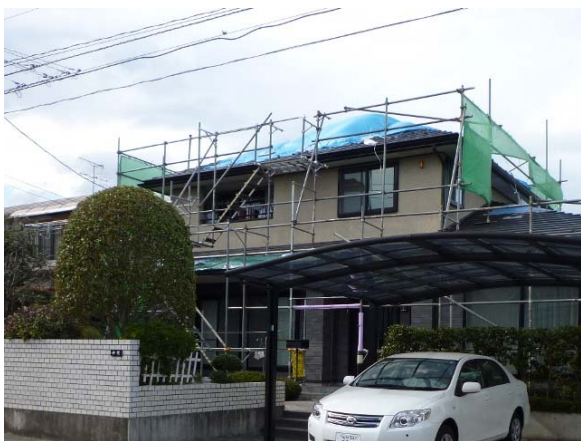
屋根瓦が落下した模様。足場を設置して工事中。
