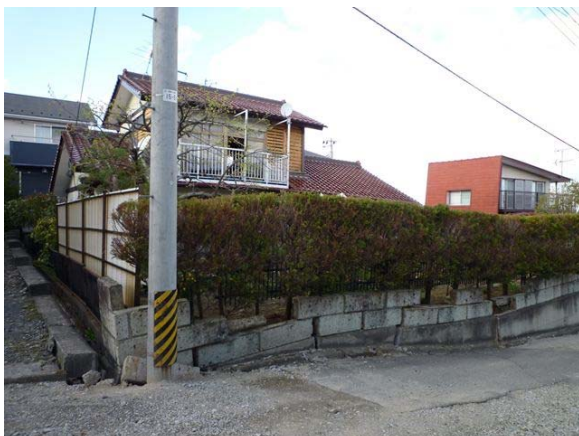
道路及び石塀の損傷状況。
