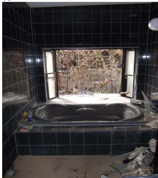
進入した水は建物端の浴室窓から流出したものであると思われる（オーナー談）。
