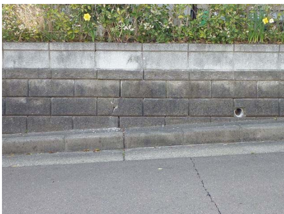
調査事例 1A-4 の近隣での擁壁の損傷。
