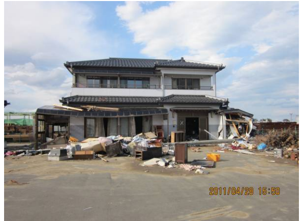
1 階が津波被害を受けた木造の例
