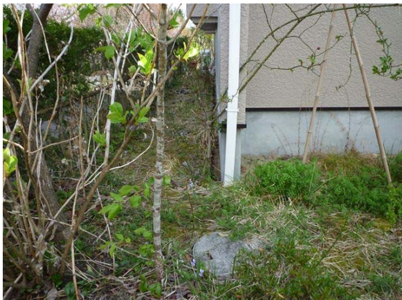
基礎の脇に生じた地盤の隙間。
