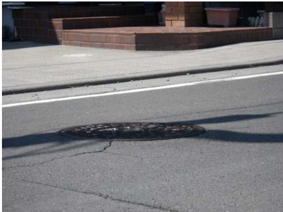
前面道路のマンホールの隆起現象。
