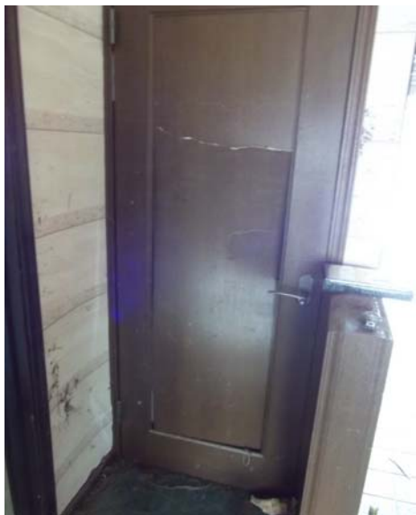
水圧により凹んだ内部建具
