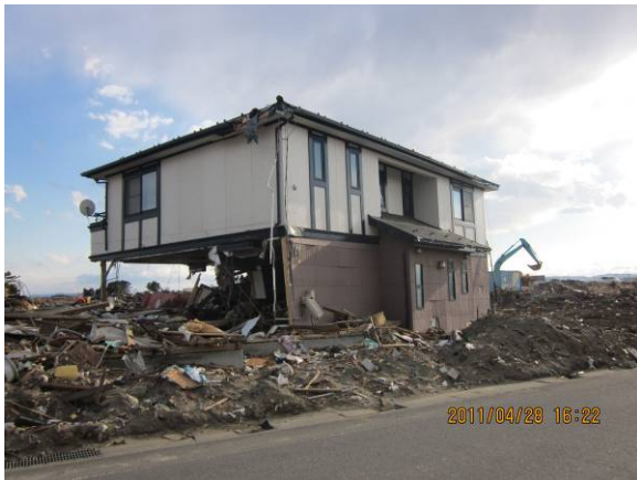
仙台空港正面ゲート付近。かろうじて自立している木造建築物
