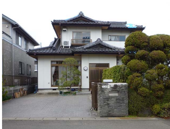
調査事例 1A-6 の近隣での屋根瓦の被害。
