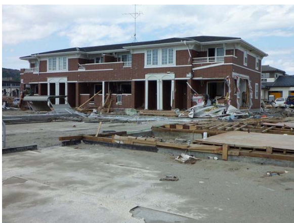
枠組壁工法による集合住宅の津波被害。
