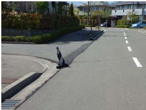
調査事例 1A-2 に向かう道路の段差。
