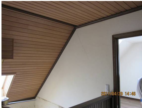
クロスに亀裂
