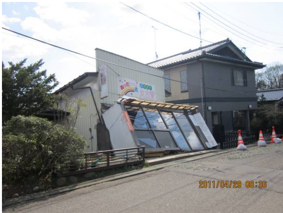
1F 店舗部分の倒壊
