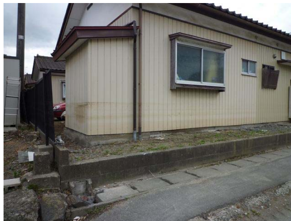
調査事例 2A-2 の近隣での浸水痕跡。
