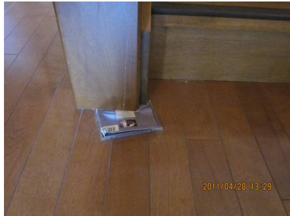
階段手摺下に CD ケースが挟まって抜けない、一度壁が浮いたか。瞬間的に建物が浮いた？
