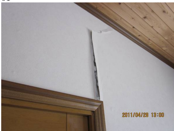
1階石膏ボードのクラック
