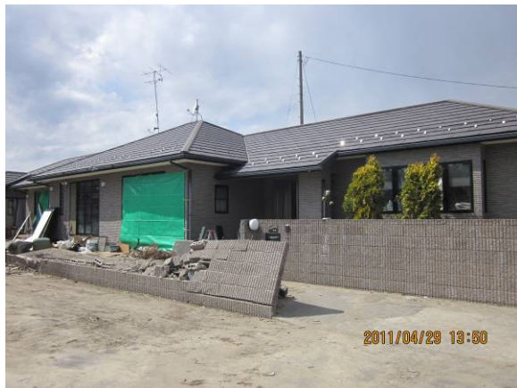
南側の掃き出し窓 2箇所より海水侵入
