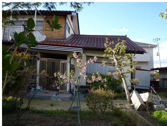
地盤変状による木造住宅の大破。
