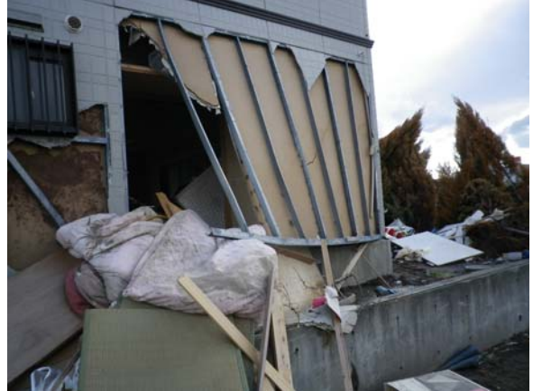
写真 35 建物；水の流れた跡
