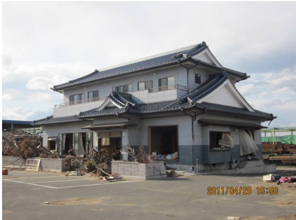
1 階が津波被害を受けた木造の例
