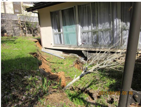
基礎が無筋かつ土台アンカーが見当たらない
