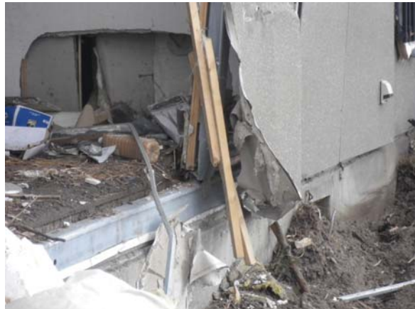
壁パネル破壊
