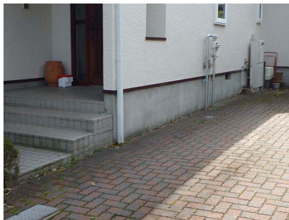
玄関周りの基礎仕上げモルタルの損傷。
