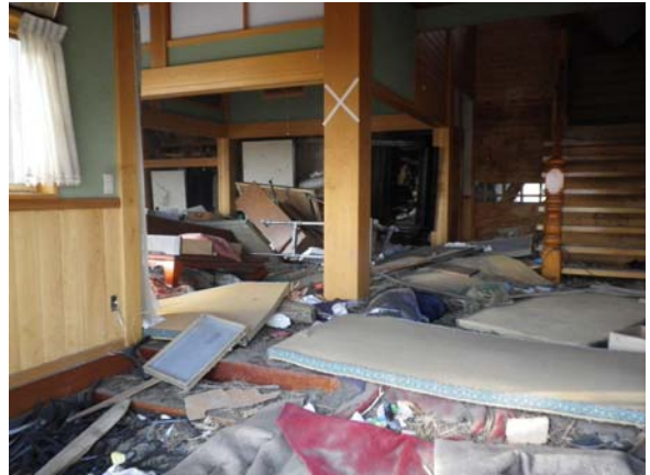
写真 32 建物；内部被害状況
