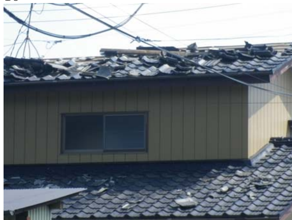
瓦屋根の被害例
