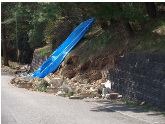
折立小学校への通路脇の間知の崩壊
