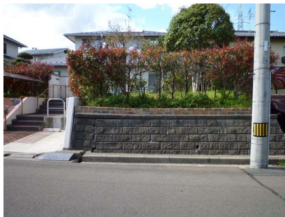
擁壁の損傷状況。
