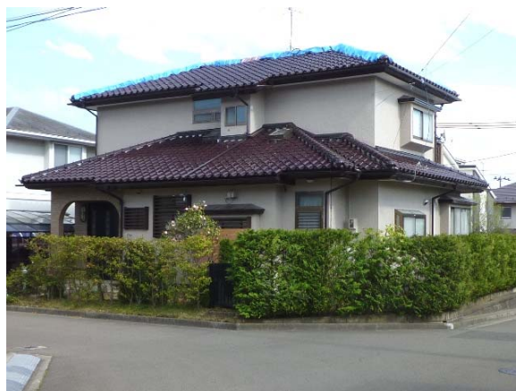
調査事例 1A-4 近隣での瓦屋根の被害。
