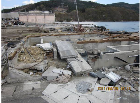
基礎から破壊されている木質系住宅
