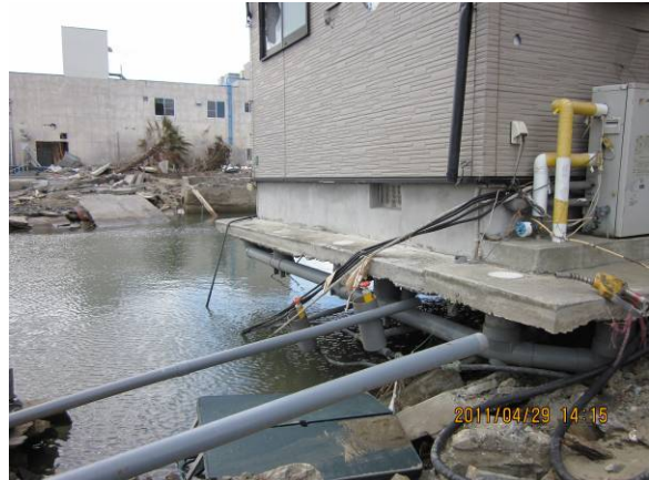
基礎下現れる
