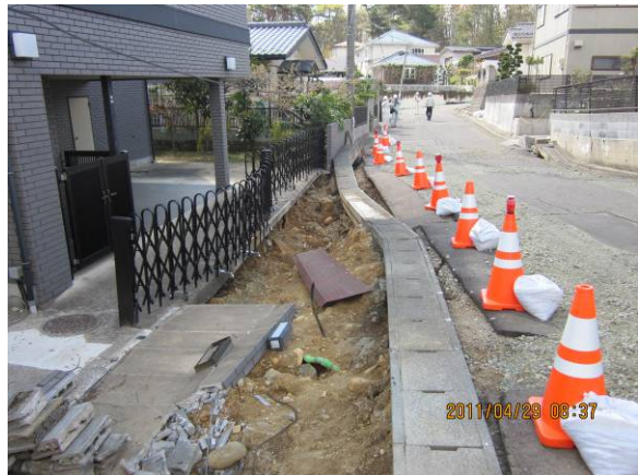
道路と高低差；宅地全体がすべっている？
