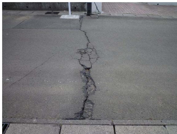
調査事例 1A-7 の前面道路の亀裂。
