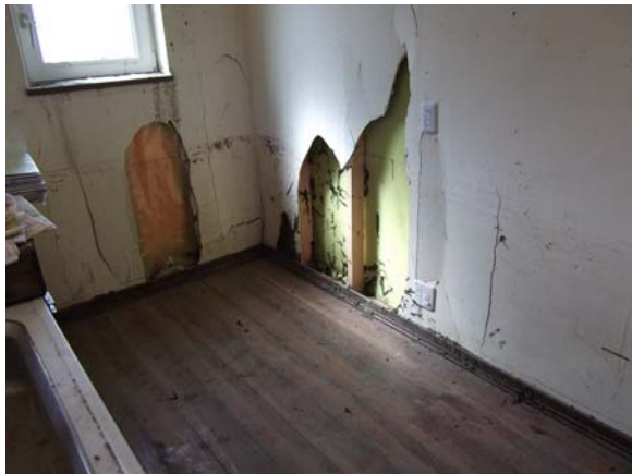
ボード圧壊している (コーナー部)
