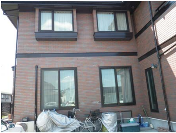
外壁タイルのひび割れ、剥落
