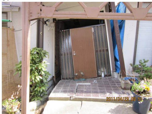
玄関周りの損傷
