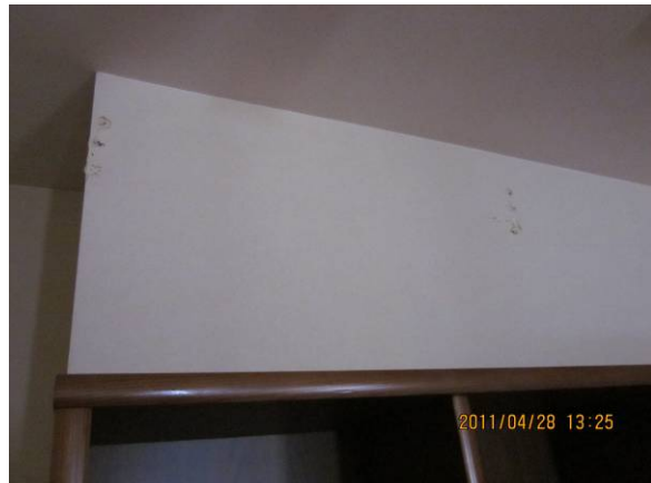
2F ホール本棚上部の吊戸棚はビスで打ちつけていたが外れて落ちた
