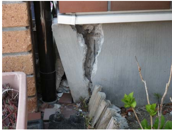
耐力壁の沈み込みによるものと思われる基礎隅角部のコンクリートの圧壊。(南面より撮影)
