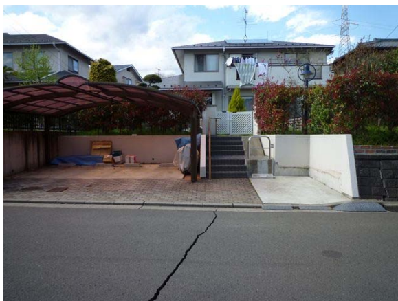
外観。道路に亀裂あり。
