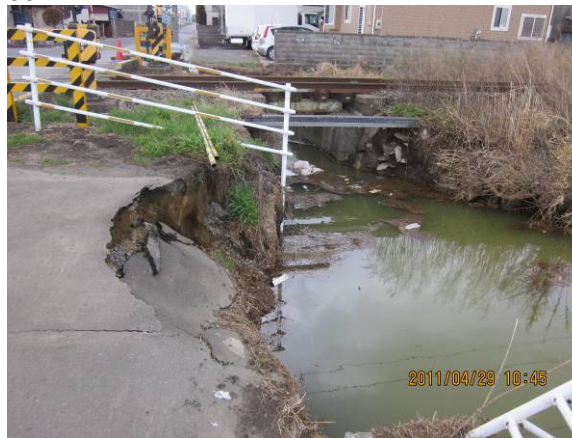
陥没踏切奥が海側（住宅地）。道路端が用水路側に崩落している。
