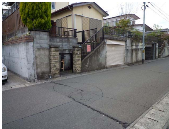
調査事例 1A-7 から東に 1 ブロックでの道路亀裂、及び車庫の被害。
