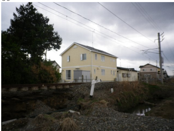
線路の枕木の被害状況
