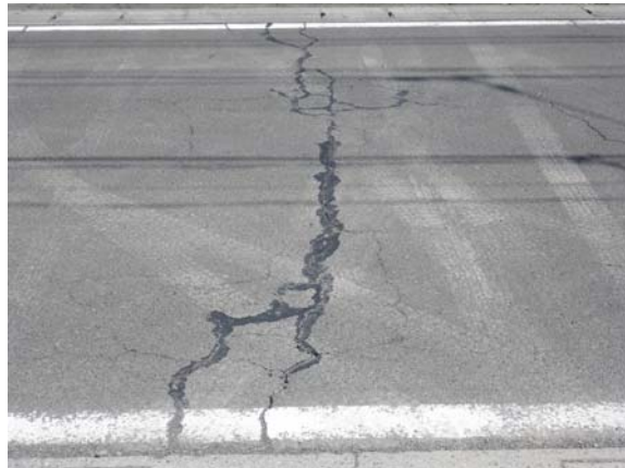
前面道路の亀裂現象。
