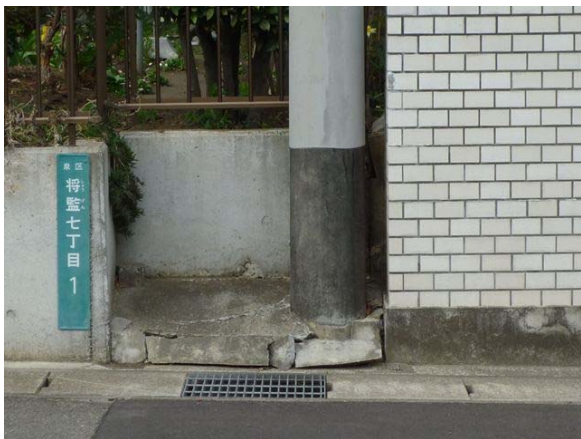
敷地隅の電柱の脚部周辺の損傷。
