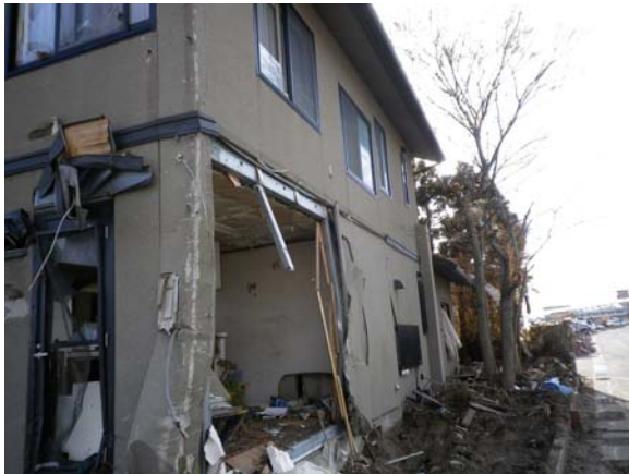
仙台空港正面付近。かろうじて自立しているS造建築物
