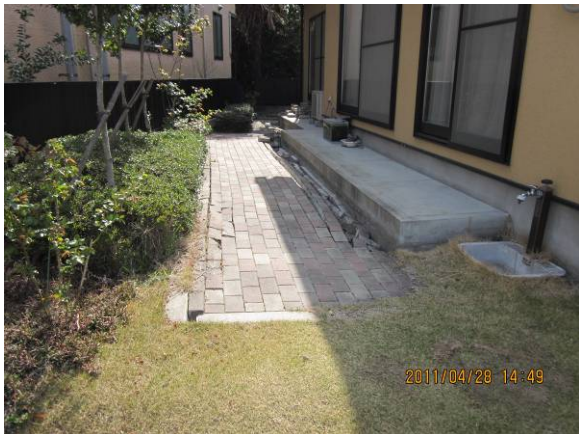
調査事例 1B-2 の隣家；地盤の隆起とひび割れ
