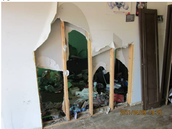
住宅奥のお風呂場近辺に荷物が流されていることから、住宅の中の水の流れが分かる。
