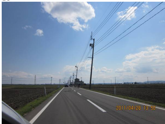
電線が西方向に倒れている(進行方向：南)
