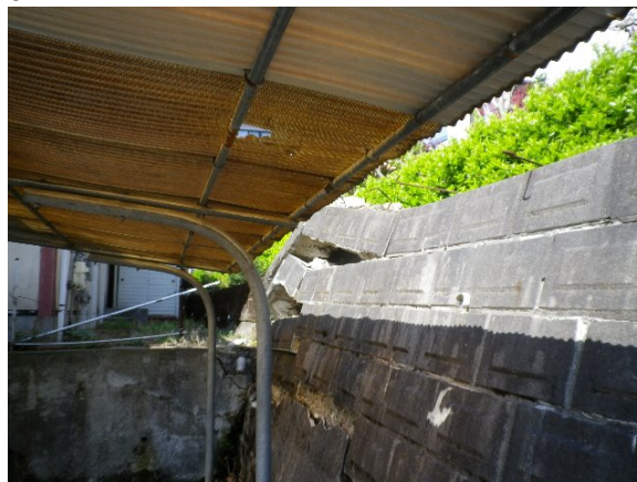
間知擁壁の座屈
