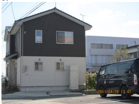
転倒防止のためエコキュートを縛ってある
