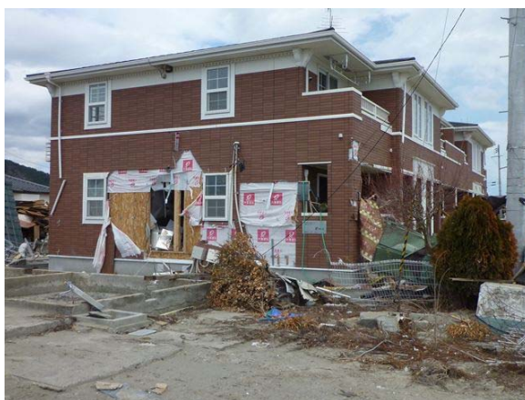
妻面の外壁は漂流物の衝突のためか仕上げが損傷し、下地の構造用パネルが現れている。
