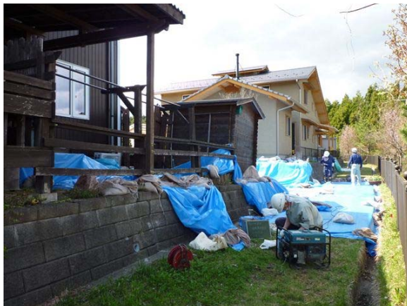
調査事例 1A-1 の近隣での被害状況。
