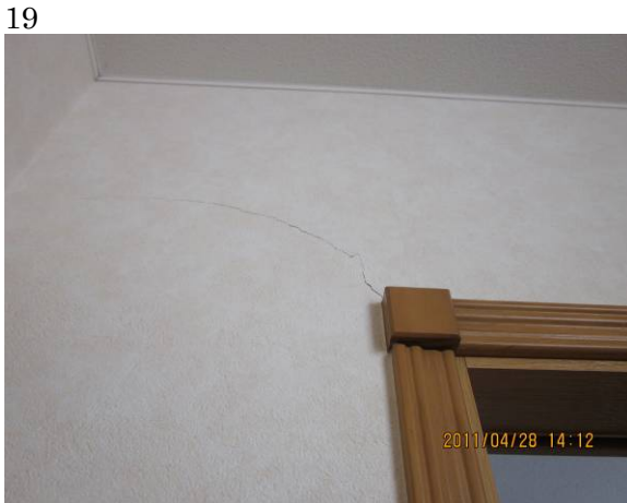
壁クロス割れ、石膏ボードは？
