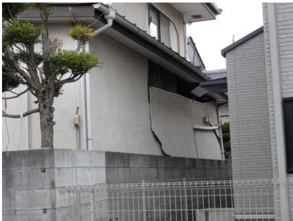
写真 64 近く。外壁の剥落が生じている住家
