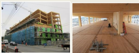
ARBORA プロジェクト（モントリオール） 8 階建てコンドミニウム（1 階 RC） 柱・梁集成材、床・壁 CLT
