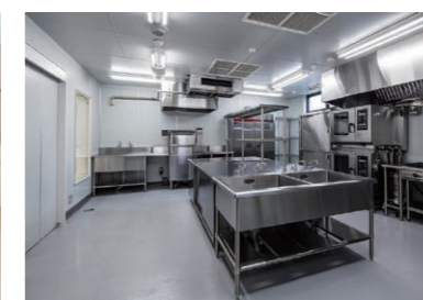
1階の調理室。不燃材が施工され、床は防滑塗床塗装を施す。設備機器は作業を重視した材料、配置になっている。
