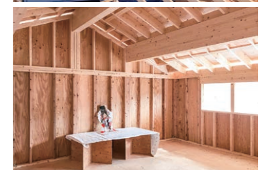
構造物の九州産材使用率は5割以上。
