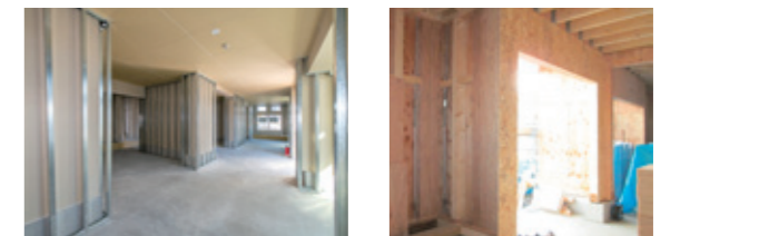
1階は天井高約3.1mを確保。木造の構造躯体を守るため、テナント工事にLGS下地が先行して施工されている。
