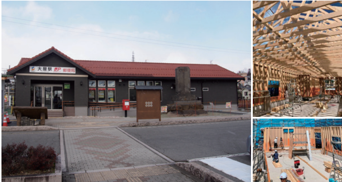
上：日本郵便としなの鉄道が互いに連携協力することで長野県のにぎわい創出に寄与するような建物をめざし建てられた。地域で長く親しまれてきた赤い屋根を採用した、ノスタルジックな外観デザインとなった。右上：建物の屋根を全面的に頑強なトラス構造にすることにより、無柱空間が構成された。右下：駅舎・郵便局の床組みをせず、壁を建てていく工程。
