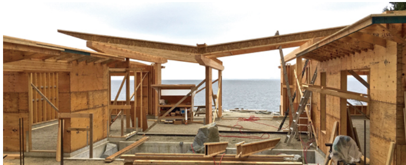
バタフライ屋根は集成材の梁・柱とツーバイフォー材の組み合わせでつくられている。※カナダならではの構造方法。
