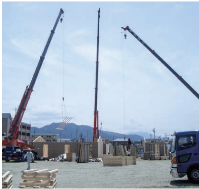
写真9 福島県会津若松市に建設した応急仮設住宅の施工の様子。プレカットやパネル製作により、現場作業が省力化された。
