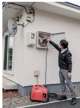
災害に強い「在宅避難ができる家」を掲げる建設会社の提案により、停電等への備えとして、発電機をつなぐと電源が自家発電に切り替わるシステムを導入。
