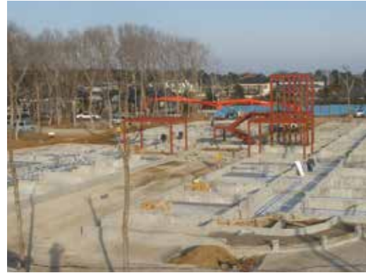
布基礎に設置された鉄骨架台
