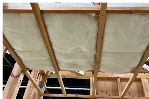
写真C 防湿フィルムを小屋裏側に向けて設置した天井施工の例
