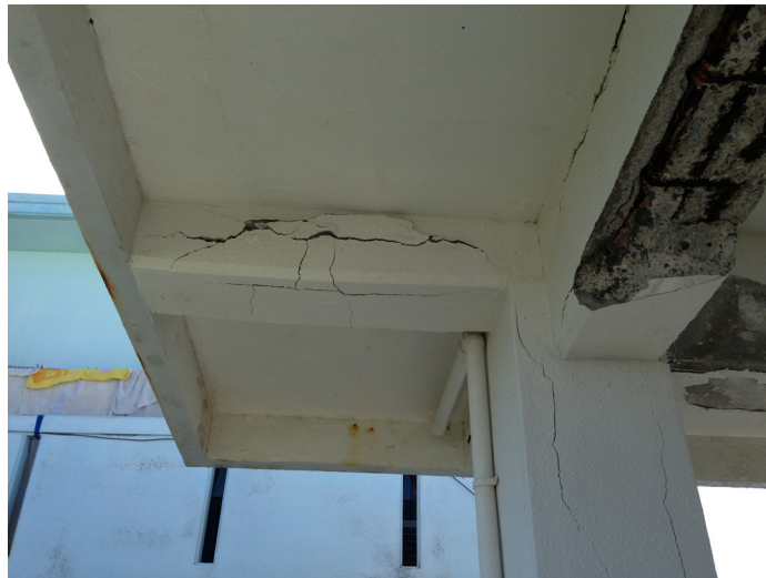
写真 2.2.7 コンクリートの劣化：剥離・剥落、鉄筋の断面欠損の状況 出典：平成 27 年風土に根ざした家づくり手引き書 沖縄県土木建築部住宅課 P24 より
