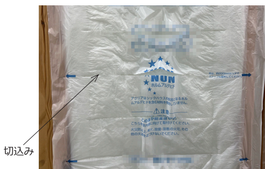
写真B 防湿フィルムの切込み加工を行った外壁施工の例
