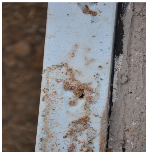
写真 2.2.11 断熱材の被害
