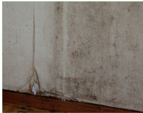
写真 4.1.2 カビによる汚損
