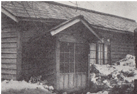
写真 2.1.1 凍上による被害
