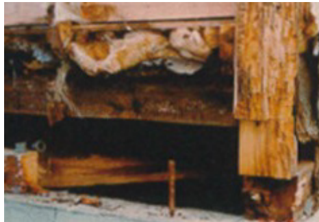
写真 4.1.3 結露による腐朽
